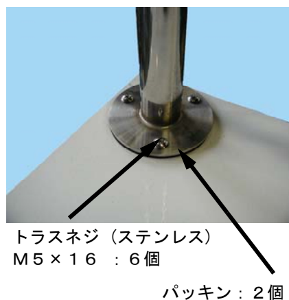
ブーム取付部
