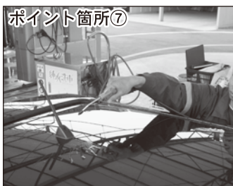
ポイント箇所⑦ アンテナ
